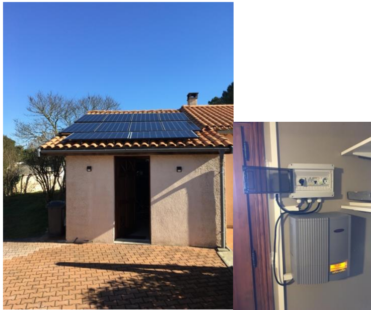
Exemple d'installation (3kWc), sur le toit d'un garage
