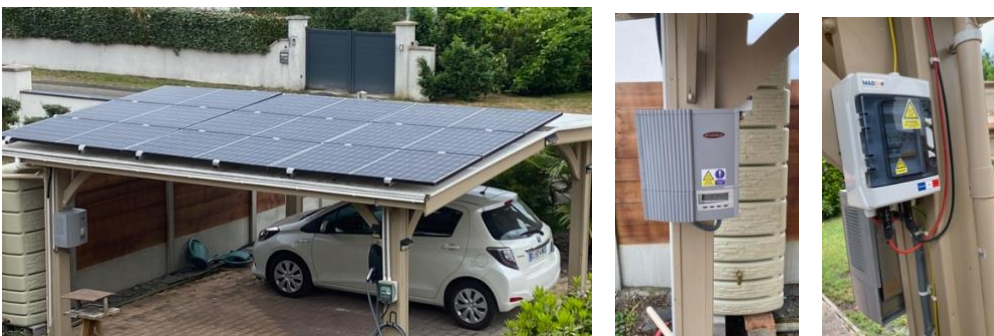
Exemple d'installation (3,3kWc) , sur le toit d'un abris de voiture (Carport)
